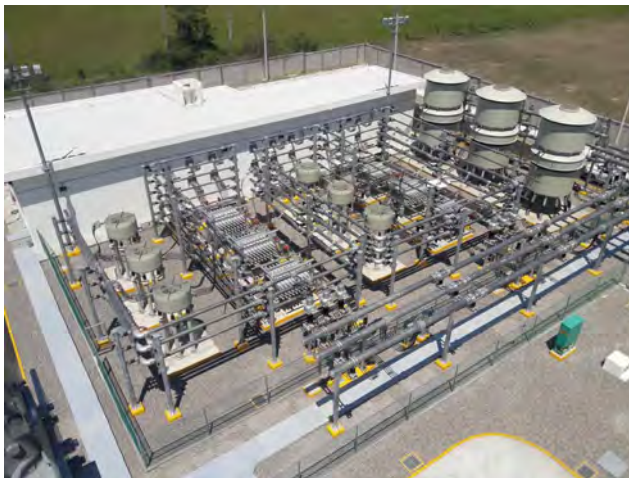
Рис 1. Панорамная сцена подстанции NUEVO VALLARTA
