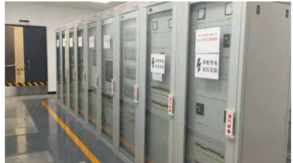
Рис. 3. Панели управления и защиты STATCOM
