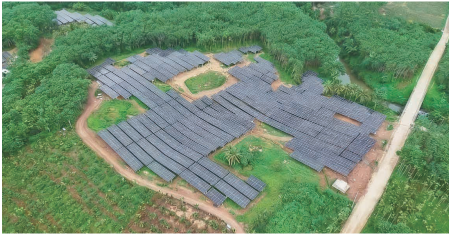
琼海阳江镇 100 兆瓦农光互补光伏发电项目光伏区
